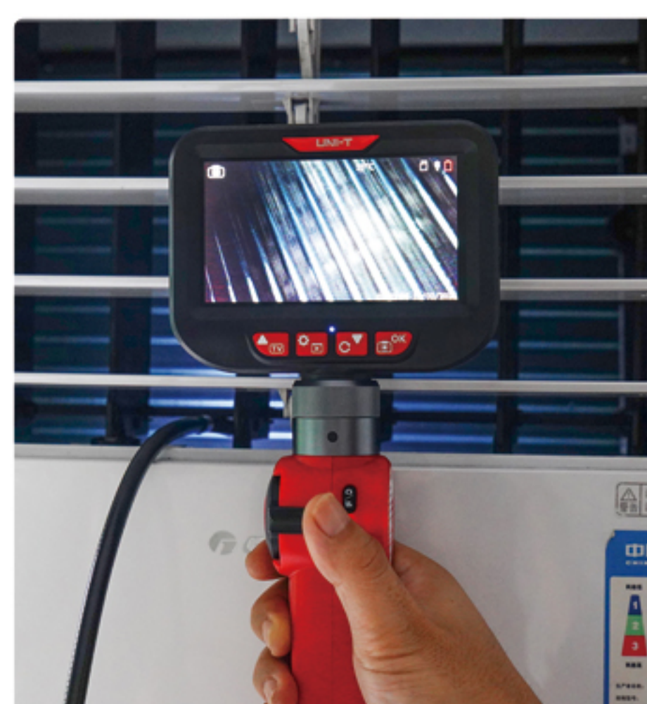
空调系统检查
