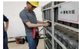
蓄电池巡检排查
