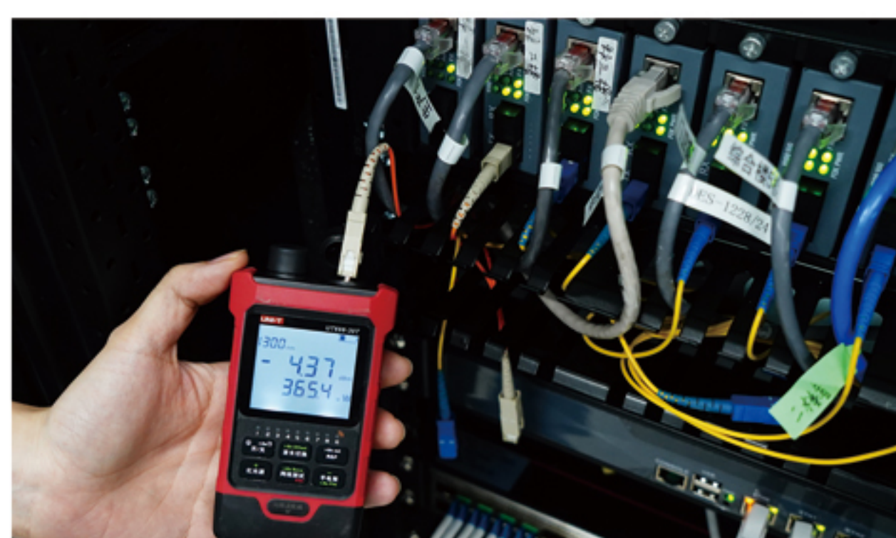
机房光纤功率测量
