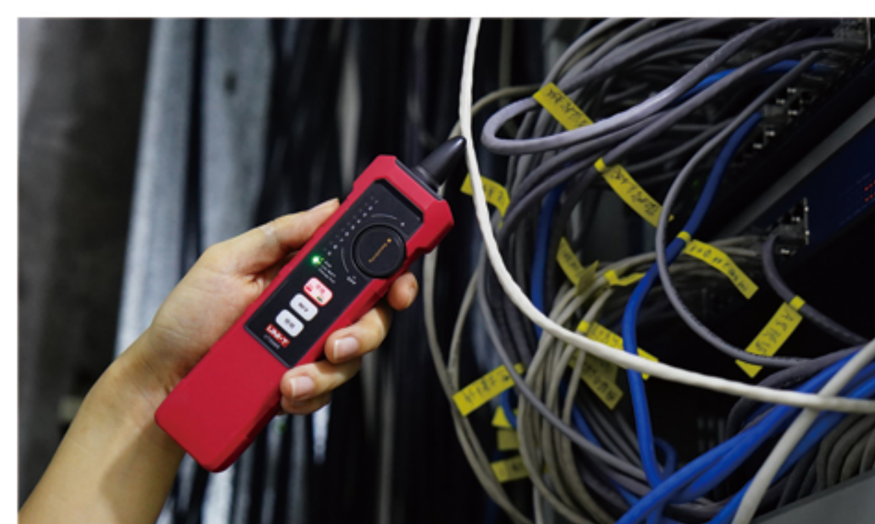
网络线缆寻线
